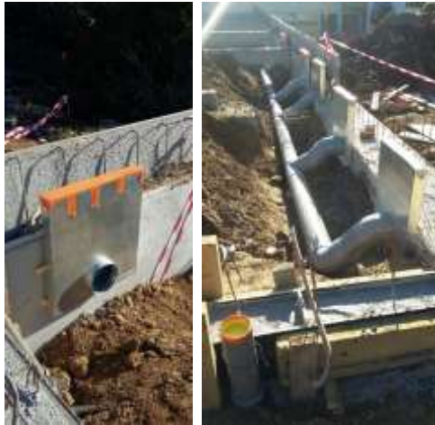
Puits thermiques de températion d'air neuf
